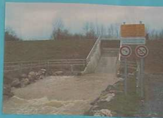
Rampe d'évacuation d'eau (GALOPIO en crue)
